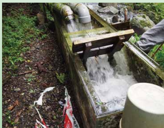
水槽タンク。手前の斜めの板がフィルター
