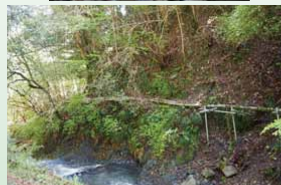
沢水は水槽タンクからの二本のパイプで 300 ㍍下流の棚田の溜池へ運ばれる
