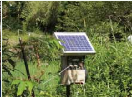
電気柵用のソーラー発電機
