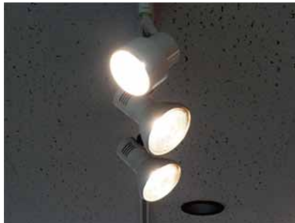
図 2 電源ダクトとスポット型照明器具
