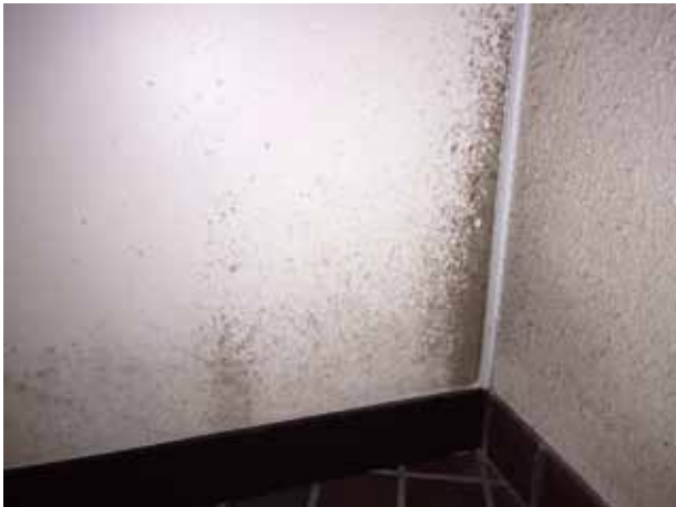
写真1：バックヤード1F廊下のカビ
