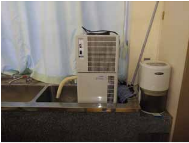
写真3：岩石・化石標本室の除湿機
